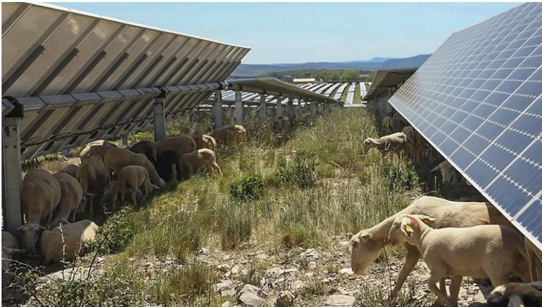
Figure 1 : Centrale solaire de Lanas, (Ardèche) - Juin 2020
